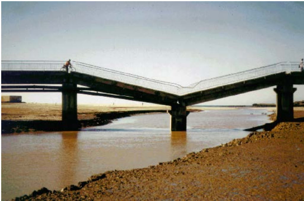
Figure 3: Enfoncement de la pile d'un pont
